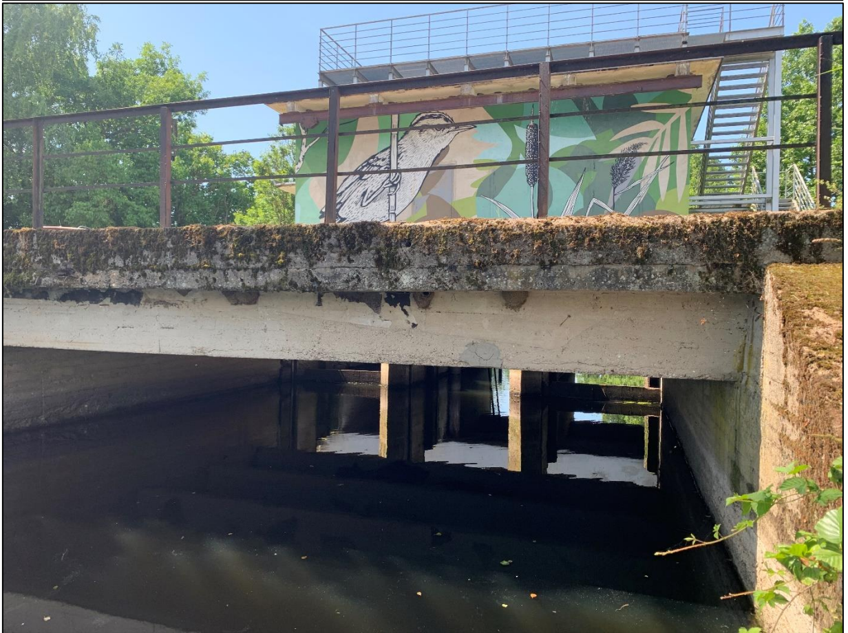
Tulkeragės melioracijos siurblinė
