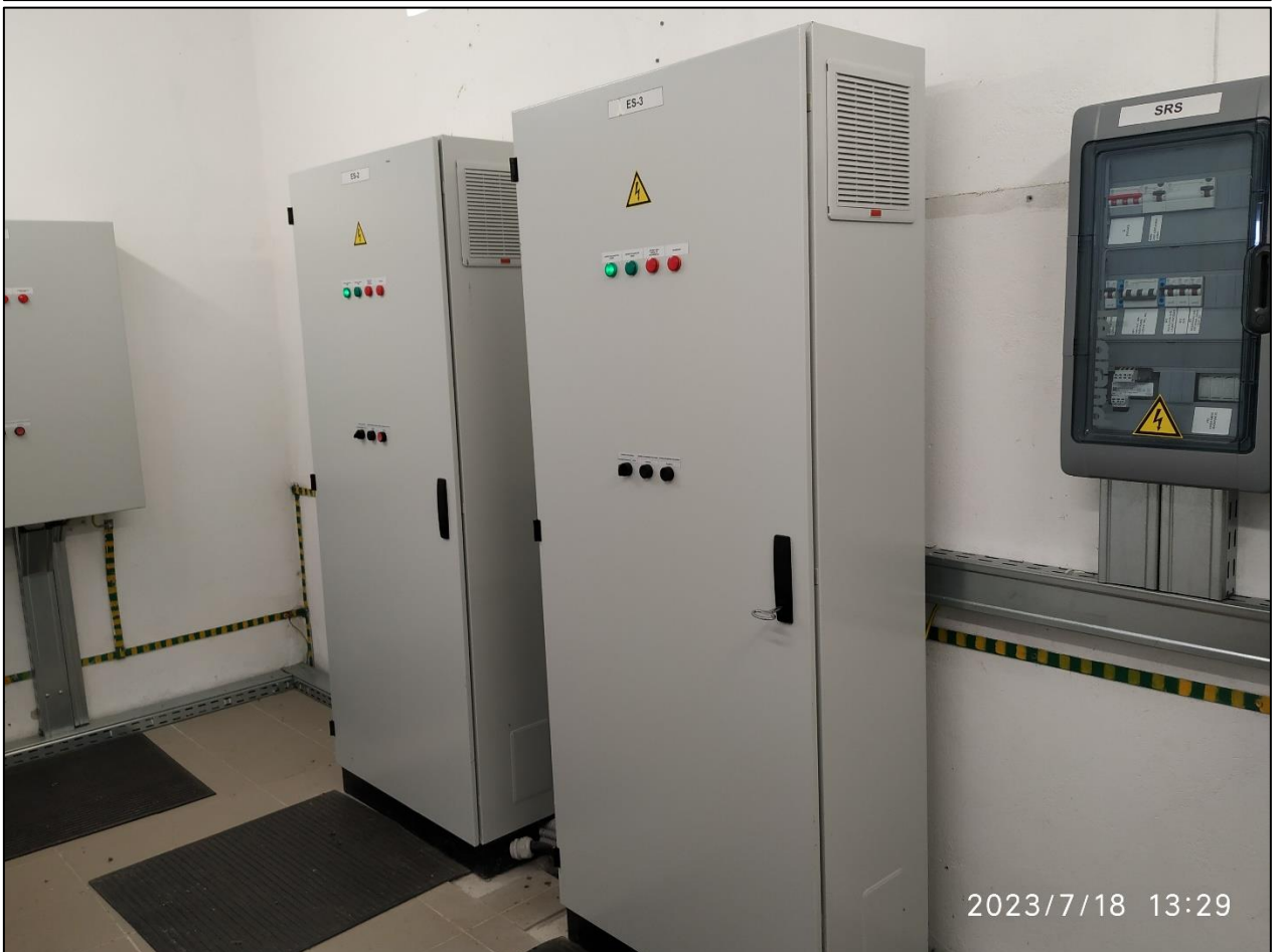
Uostadvario vasaros polderio melioracijos siurblinė
