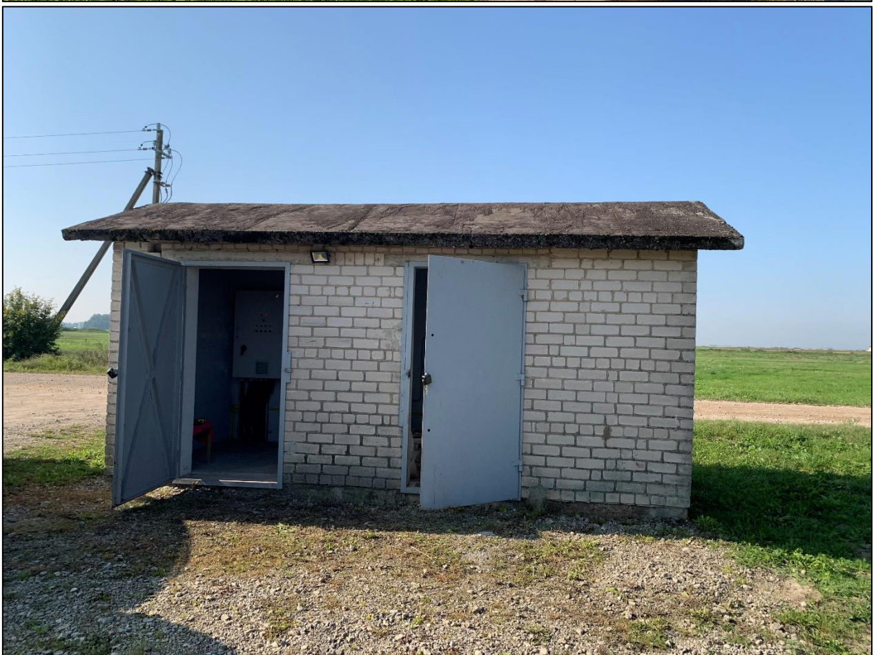
Baukštės žiemos polderio melioracijos siurblinė
