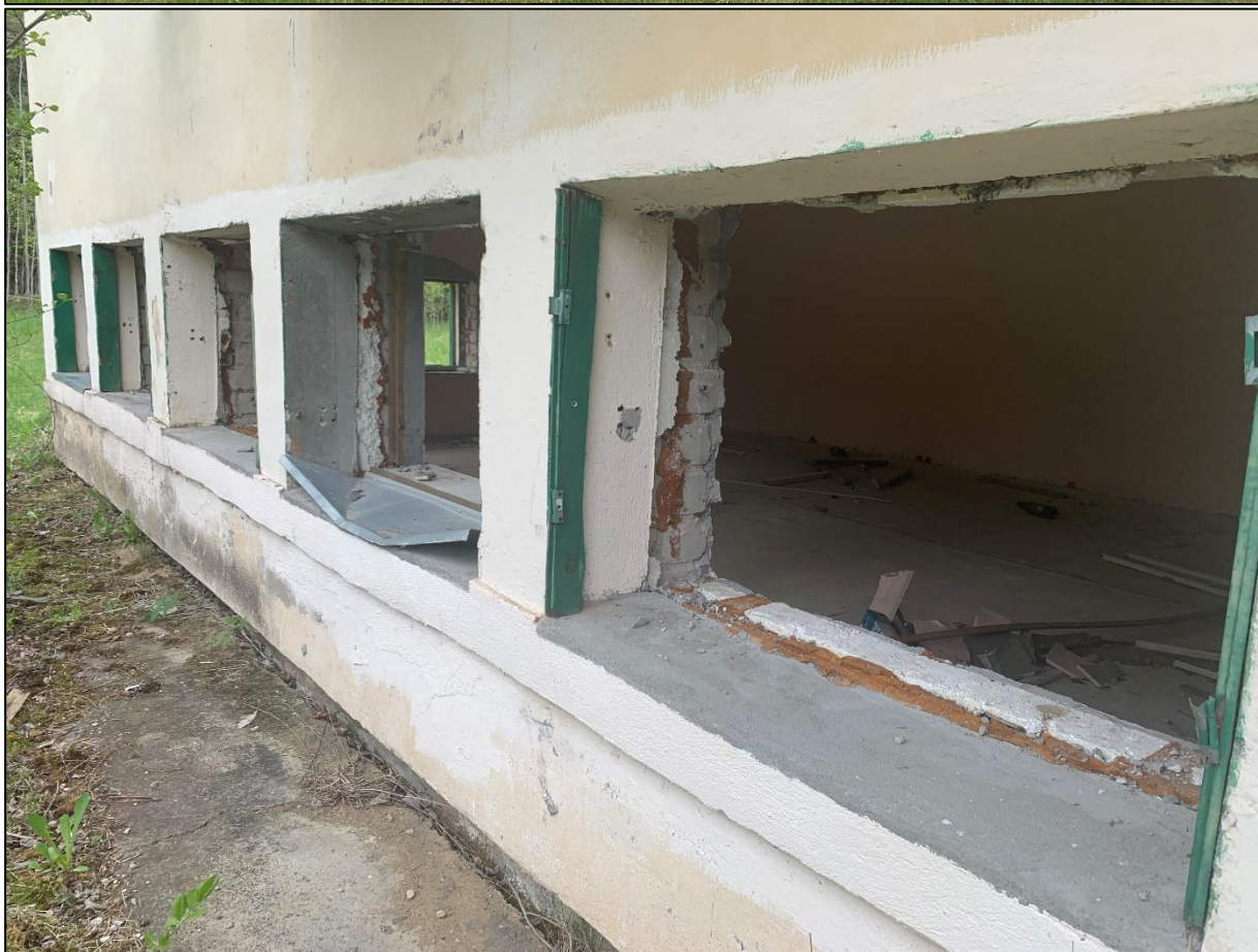
Reškutėnų melioracijos siurblinė
