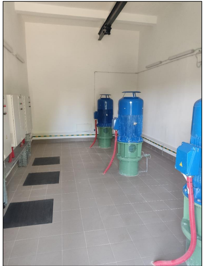
Veržės melioracijos siurblinė
