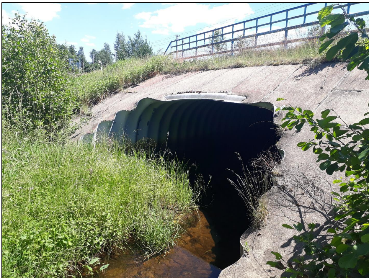
18 pav. Tilto vietoje – didelio skersmens metalinė pralaida per Talės upę (Utenos r.)
